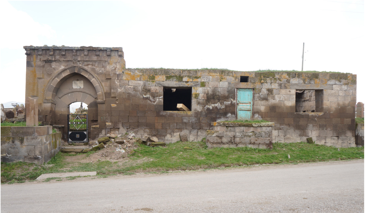
Res. 3 - Mollakent mezarlık alanında giriş portalı ve bitişindeki kâgir yapı, kuzey cephe.
